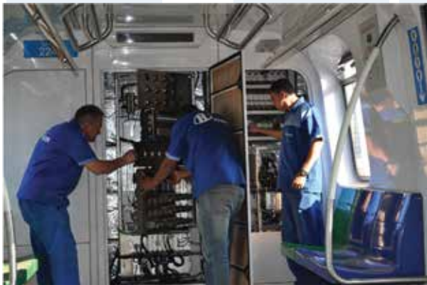
Instalação do ATO nos trens das séries 1000 e 2000 do METRÔ BRASÍLIA - MDF Assembly of ATO METRÔ BRASÍLIA - MDF
